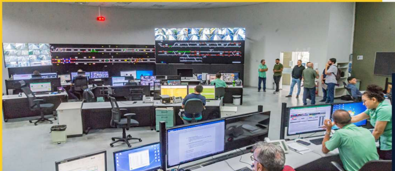
Imagem 03: Centro de Operações METROFOR na sede da empresa, em Fortaleza, Ceará.
