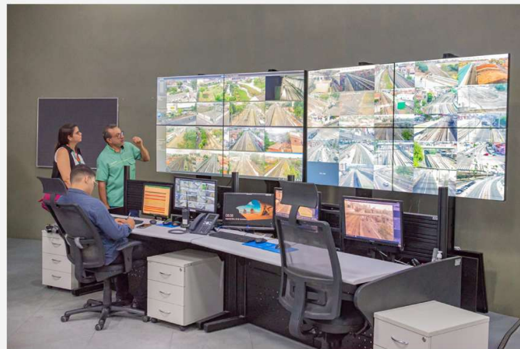
Imagem 58: Centro de Operações METROFOR.
